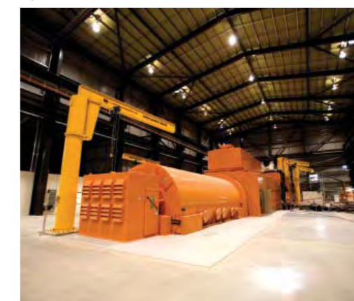
e3p turbine hall
